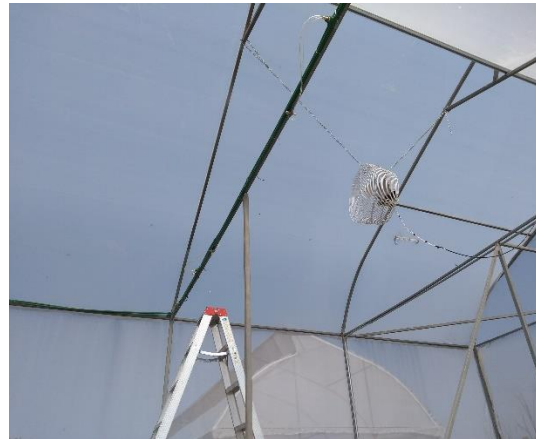
Figura 7. Nebulizador y recirculador de aire (actuadores)
