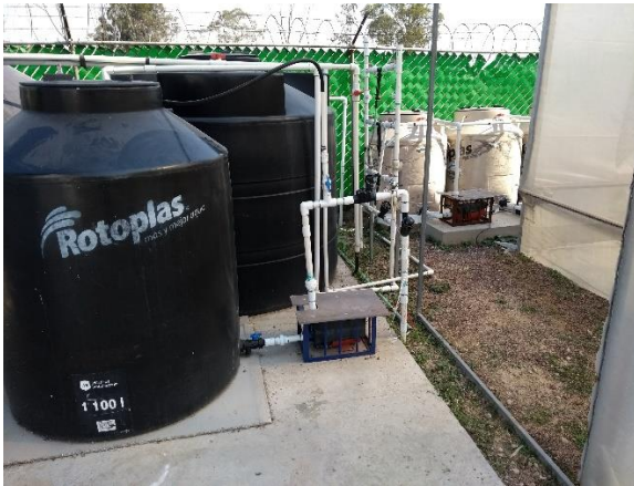
Figura 6. Bomba de riego (actuador)
